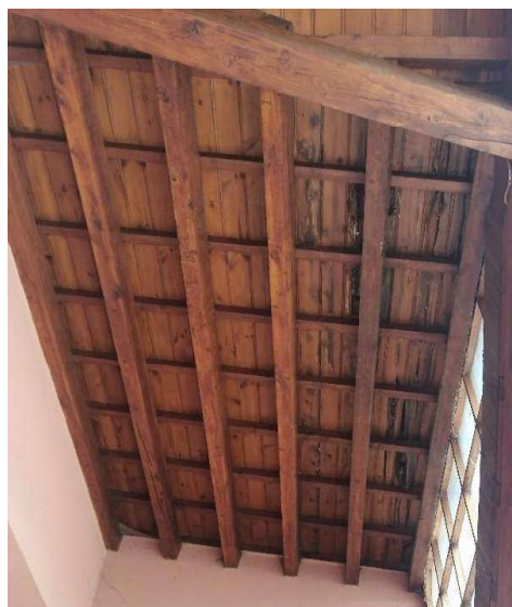
Infiltrazioni portico fronte edificio con danneggiamento della struttura portante
